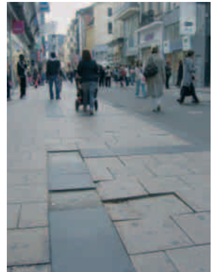
Pflasterschäden in der viel begangenen Fußgängerzone.
