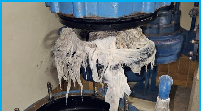
In gefährlicher und unhygienischer Arbeit müssen die Pumpen manuell von Feuchttüchern, Haaren und Fetten befreit werden.
